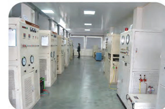
标准化实验室 Advanced Testing Room
